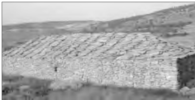
Mosqueruela. Caseta con dos falsas cúpulas por aproximación de hiladas y cubierta de lajas.
